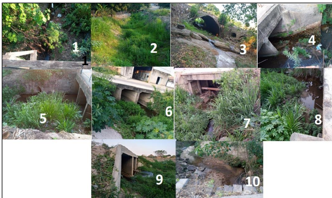
Figura 4 – Fotografias das alterações no córrego da Saúde nas seções monitorados
