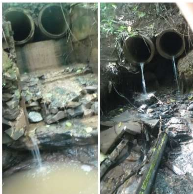
Figura 8. Desembocadura de galerias pluviais com evidência de água contaminada (Trecho fluvial III) – Fonte: Fotos dos autores (2015).
